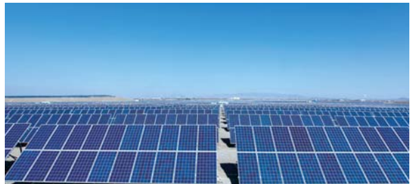
Usina Fotovoltaica de 50MW da Suntech Ulan
