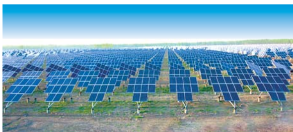
Usina Fotovoltaica de 12MW em Xuzhou mapo
