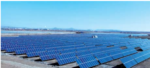
Usina Fotovoltaica de 200MW da GCL Datong
