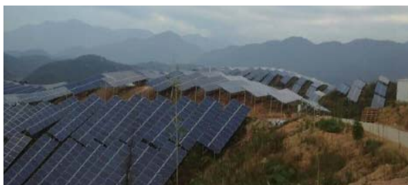
Usina Fotovoltaica de 30MW em Huadian Zaoyang
