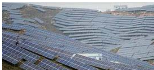
Usina Fotovoltaica de 50MW da CGN
